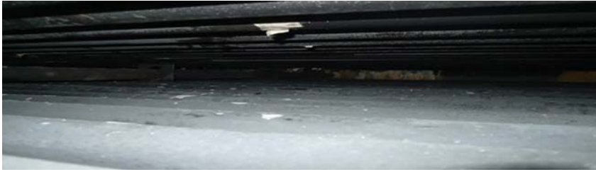
Bề mặt ống bộ hâm nước cấp I
