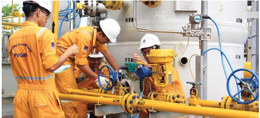
Bảo dưỡng sửa chữa Hệ thống khí PM3 - Cà Mau. Ảnh: PV GAS
