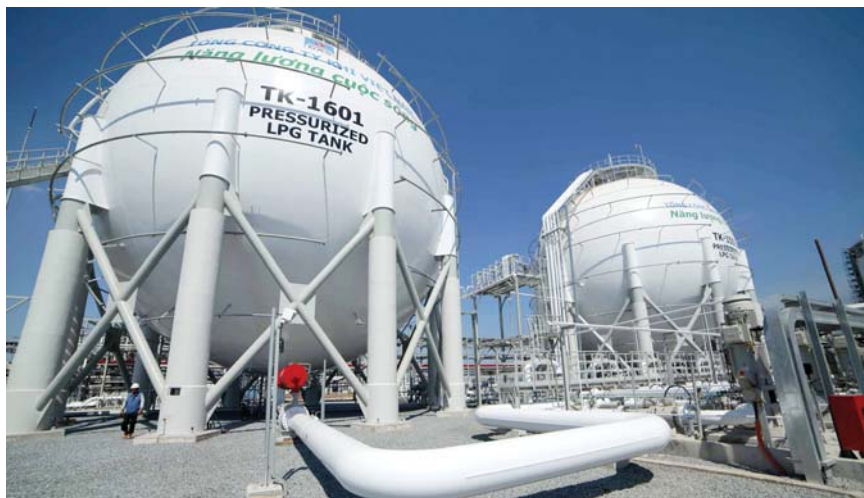
Kho LPG lạnh Thị Vải. Ảnh: PV GAS
